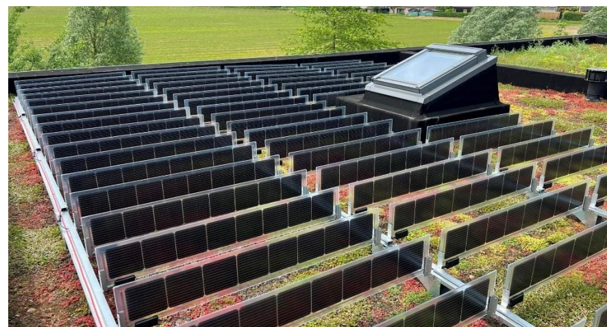
Figuur 38 Bifaciale verticale zonnepanelen op sedumdak. Bron: Solar Batteries
