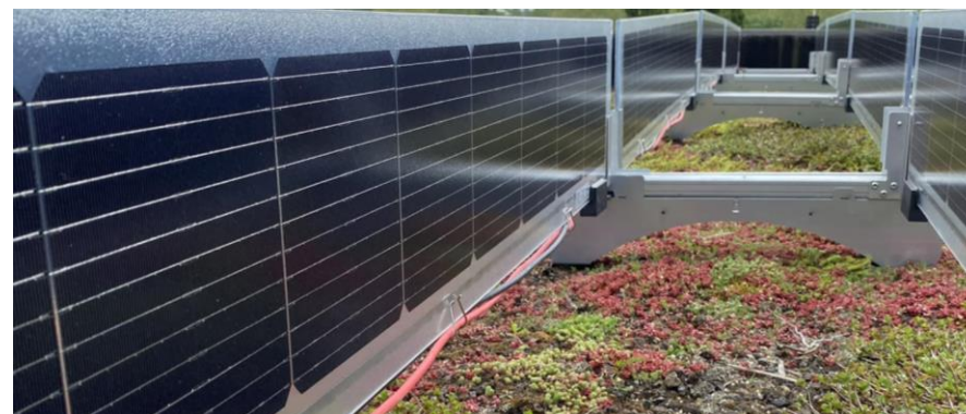
Figuur 39 Bifaciale verticale zonnepanelen op sedumdak. Bron: Solar Batteries
