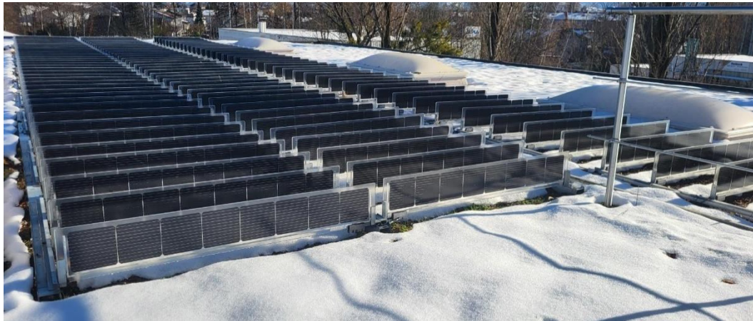
Figuur 19 Verticale zonnepanelen bij sneeuwval - Oostenrijk. Bron: Over Easy Solar
